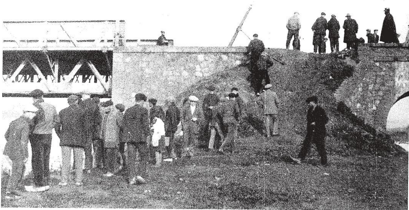
Obres de reparació del pont del Besòs. Fotograma extret del documental de Carles Nyssen sobre aquest tema, 1928.
